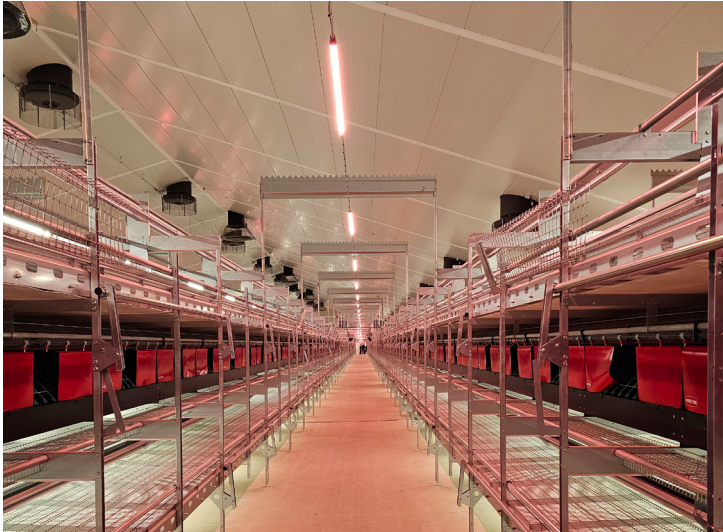
Deckenbeleuchtung montiert in einem Legehennenstall mit Etagensystem.
