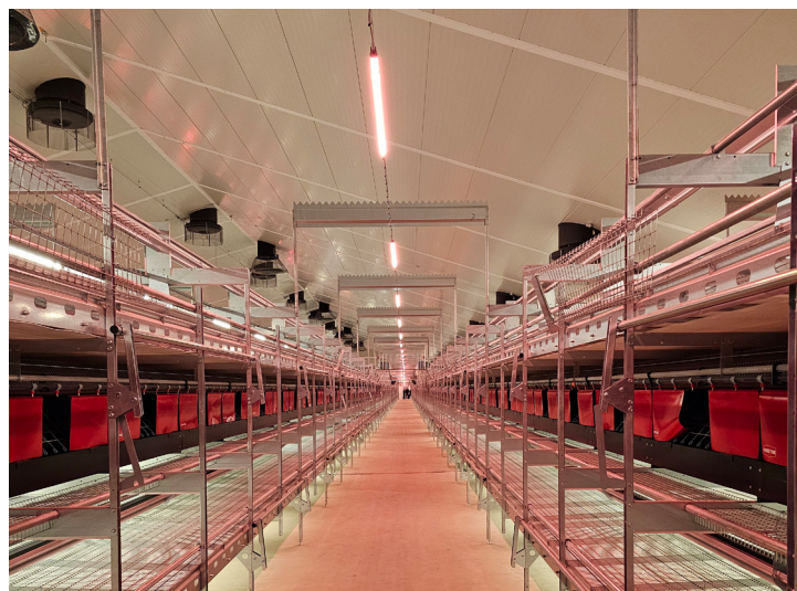
Loftbelysning monteret i æglæggerhus med etagesystem.
