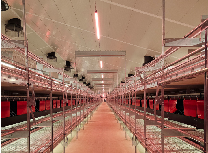
Iluminación de techo instalada en una nave de ponedoras con sistema de varios pisos.
