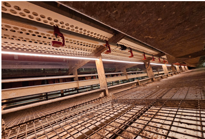
AVIARY-LIGHT instalada bajo el sistema de varios pisos.
