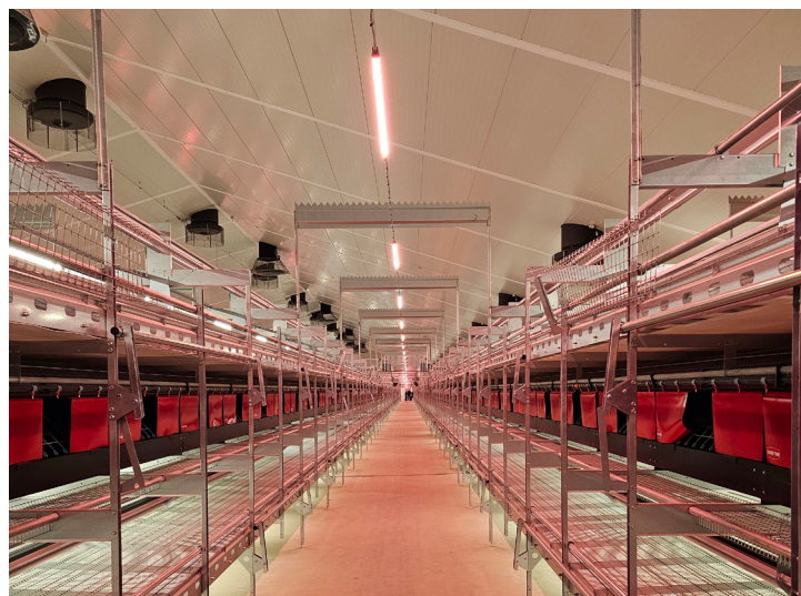
Oświetlenie sufitowe zamontowane w kurniku dla niosek z systemem wielopoziomowym.
