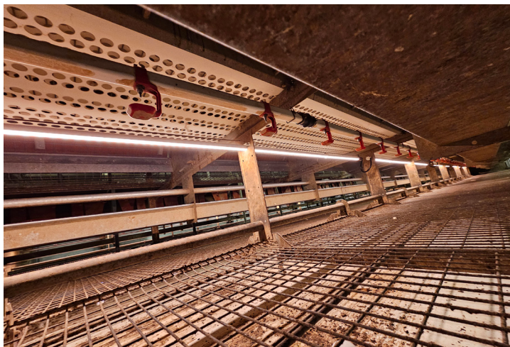
AVIARY-LIGHT monterad under våningssystemet.
